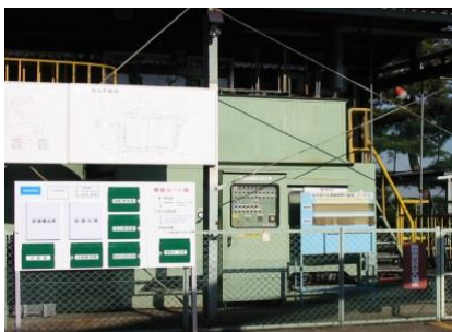
排水処理設備の定期点検等管理板
